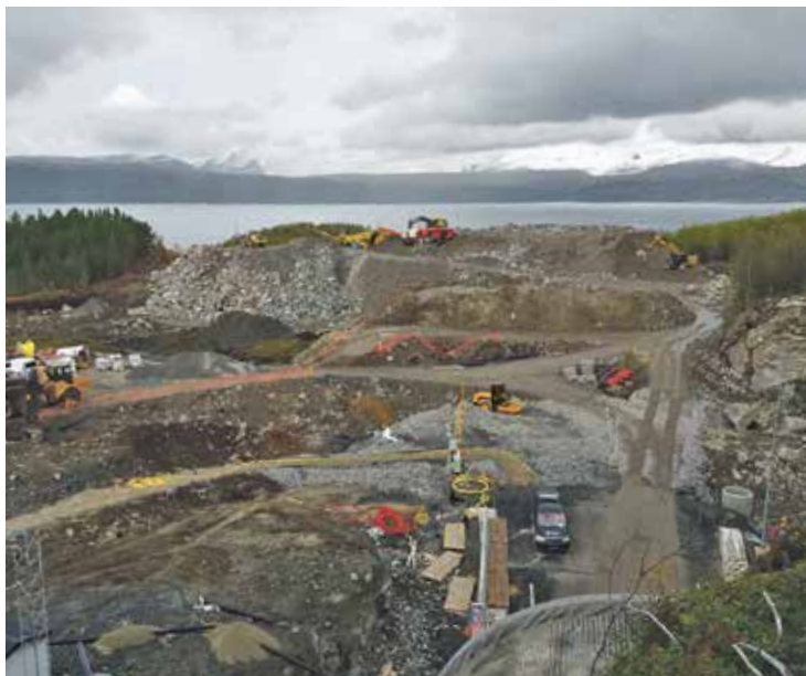
TOMTA: 70.000 kubikkmeter med sprengte masser fra tunnelen erstatter myr og løsmasser på sykehustomta.
