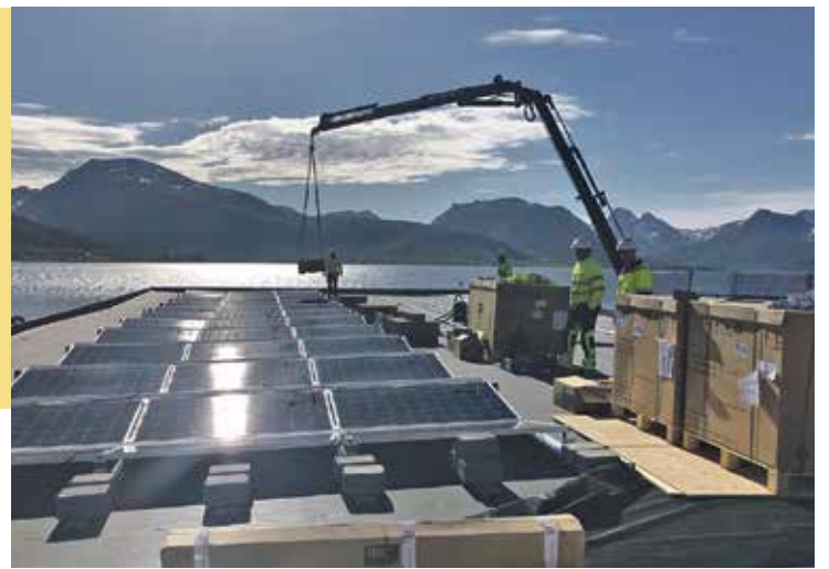
FORNYBAR ENERGI: 500 kvm solcellepaneler dekker tak og deler av fasaden ved El-Team's avdeling på Sortland. Leverandøren Berggård Amundsen & Co AS bisto ved installasjonen av anlegget som blir et referanseprosjekt i regionen. Foto: Berggård Amundsen & Co AS.
