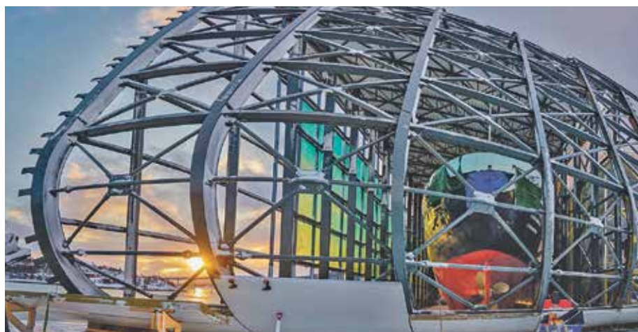
STÅLKONTROLL: Underveis i byggeprosjektet: Rammen av stål har kommet og er klar for innsetting av glass. Foto: Peab Bjørn Bygg/ Ørjan Marakatt Bertelsen
