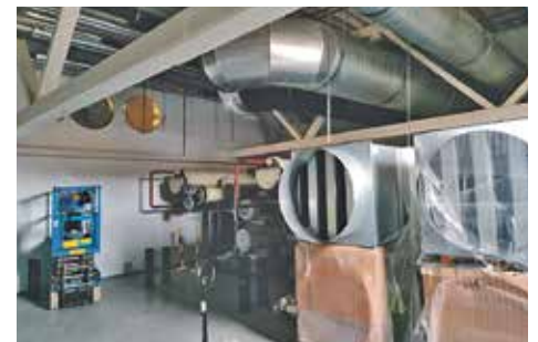
RSV-ANLEGGET: Både ventilasjon, elektro og VVS ble levert av Caverions avdeling i Bodø. Foto: Salten Aqua
