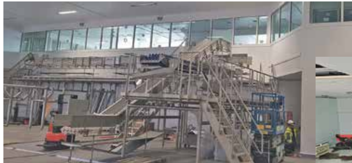
RUSTFRITT: Store mengder rustfritt stål gikk med til å bygge opp det nye slakteriet. Foto: Moldjord bygg og anlegg AS
