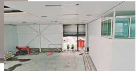
HALL: I denne hallen skal pakking og sortering foregå. Foto: Salten Aqua
