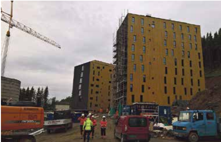
VERDISKAPING: Bygg- og anleggsbedriftene med hovedvirksomhet i landsdelen sto for en samlet verdiskaping på i overkant av 10 milliarder i 2019. Bildet er fra første byggetrinn ved Dramsvegen Panorama studentboliger, der Econor AS var totalentreprenør. Foto: Econor AS
