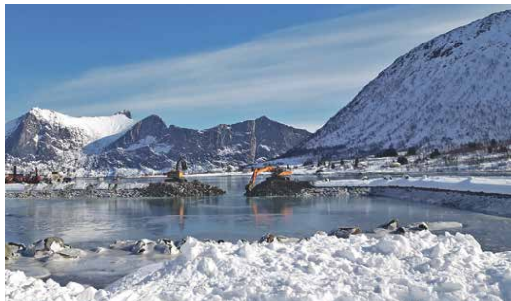
MOLO: En omfattningsmolo bygges rundt området som snart skal fylles opp med masser fra mudringen. Området på 50 mål blir et av to nyetablerte næringsareal. Foto: Martin Dreyer Ingebrigtsen - Senja kommune
