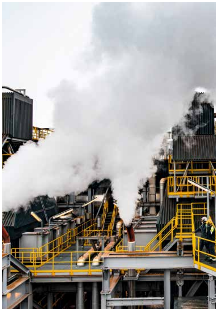
I 2012 ble det installert et energigjennvinningsanlegg ved Finnfjord AS, en dampturbin som i dag kan produsere 340 GWh elektrisk kraft. Foto: Finnfjord AS / Tommy Stefanussen
