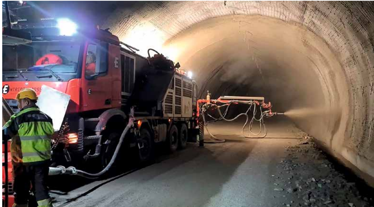
Ekstremt dårlig fjell forsinket arbeidet i Skarvberg-tunnelen med 12 måneder. Foto: Statens Vegvesen
