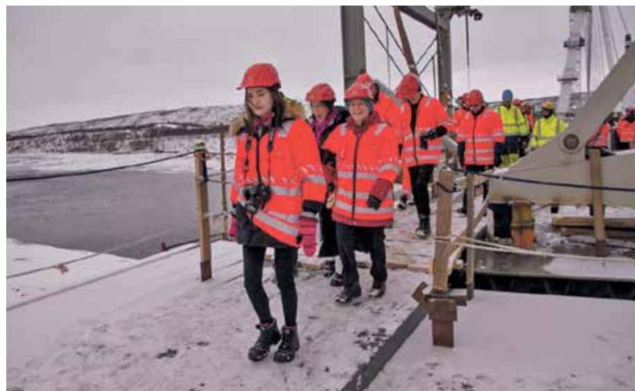
MILEPÆL: 23. oktober i fjor var nye Tana Bru landfast. Ordfører Helga Pedersen (foran til høyre) var blant de første som vandret over den nye brua, sammen med representanter for Tana kommune, Statens vegvesen og hovedentreprenørene HAK Entreprenør og Vistal. Foto: Statens vegvesen
