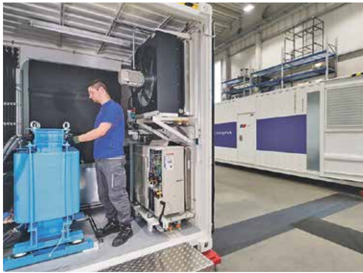
KRAFTPAKKE: Batteriet som skal plasseres på Husøy leveres av Rolls Royce Solutions. Med en lengde på nesten 13 meter blir det Norges største batteri. Foto: Rolls Royce Solutions Berlin.
