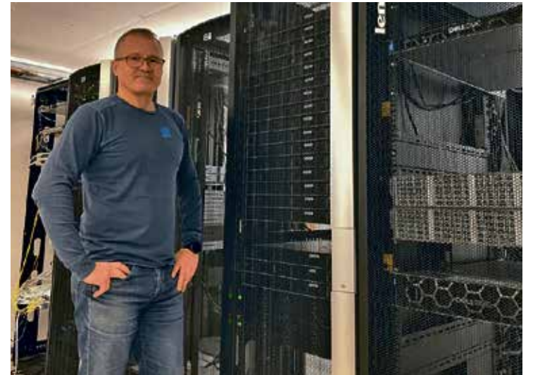
- Datasenteret står i et brannsikket bomberom med ekstra nedkjøling. Men på kalde vinterdager er dette rommet med å varme bygget vårt, så det er gjenbruk av varme, forteller Stig Mathiassen, leder for datasenteret hos Serit Tromsø.
