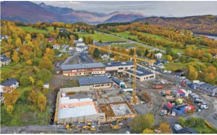
OVERSIKT: Høsten 2020 var fundament og grunnmur for flerbrukshallen ferdig, og det var klart for å starte byggingen med massivtre. Foto: Ørjan Marakatt Bertelsen
