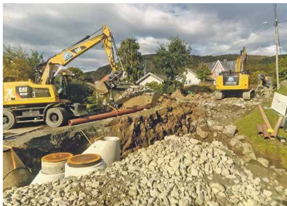
HASTEUTBEDRING: De fleste kommuner i landet har et betydelig etterslep på utskifting av gamle rør for vann og avløp. Her får en av de eldste avløpsledningene i Hadsel kommune tiltrengt førstehjelp, etter at det er påvist kollaps flere steder langs avløpet. Foto: Jonas Ellingsen
